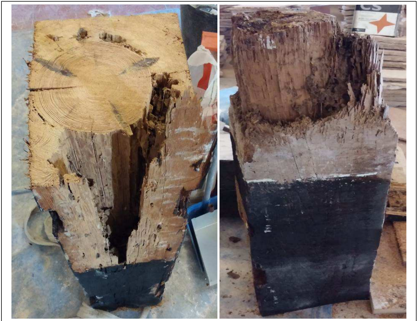
Imagen 2. Degradación de jácenas de madera de un palacio renacentista perteneciente al patrimonio histórico valenciano. Los daños ocasionados por termitas curvaron varios forjados de grandes luces.
